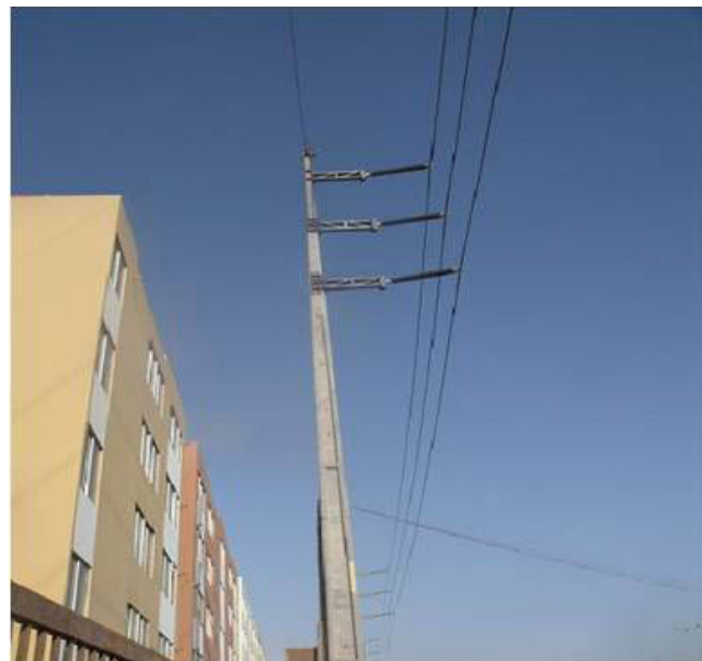
Fig. 1. Una línea de transmisión trifásica de 13,2 (KV) cuyas líneas están muy cerca de edificios de apartamentos en una zona suburbana de Chile, mostrando que el campo magnético dentro de estos pisos es del orden de 50 a 100 microteslas cuando interactúan con el microondas del teléfono inteligente.
